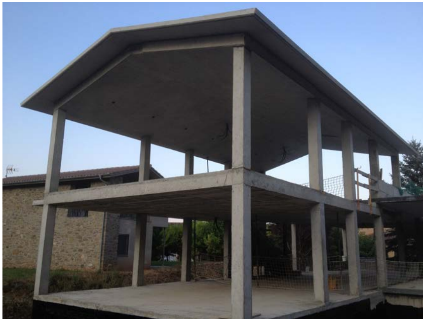
Ilustración 1 Estructura protección pasiva
