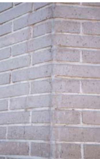
Grietas selladas con elastómero
