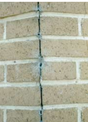
Nido de araña en grieta
