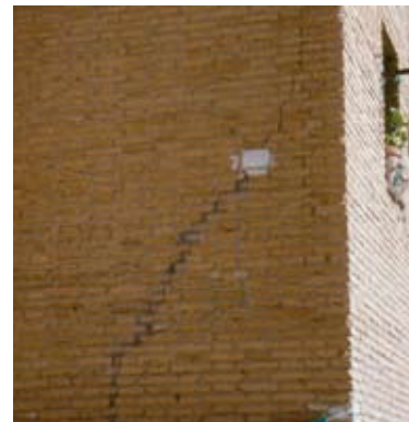
Grieta semiparabólica por asiento del terreno
